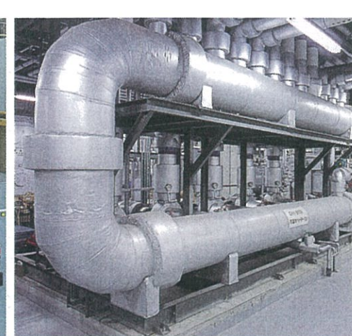
発電機からの熱を射出成形機の冷却に利用する熱交換システム
